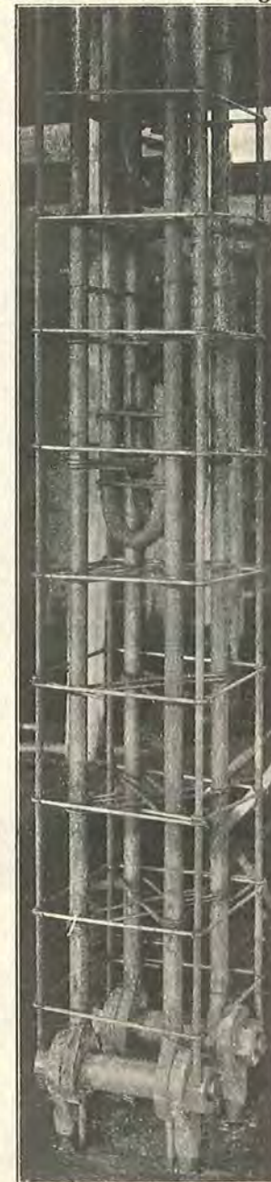
Fig. 48. Jærnindlæg i en Hængesøjle paa Christiansborg.
